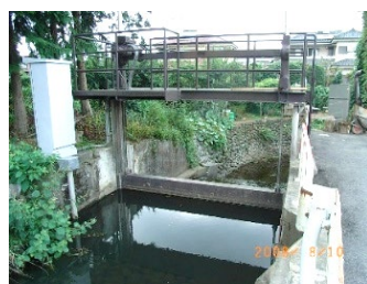
大門川取水ゲート
