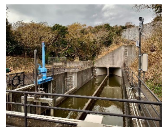
取水門の遠隔開閉装置
