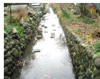
老朽化した水路
