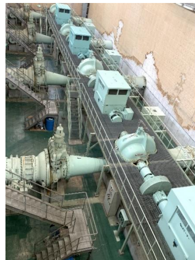
場内のポンプ設備
